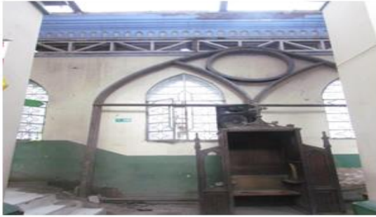
MURO COSTADO ESTE INTERIOR- EJE A - CARACTERÍSTICAS DE LOS MATERIALES Y ESTADO
