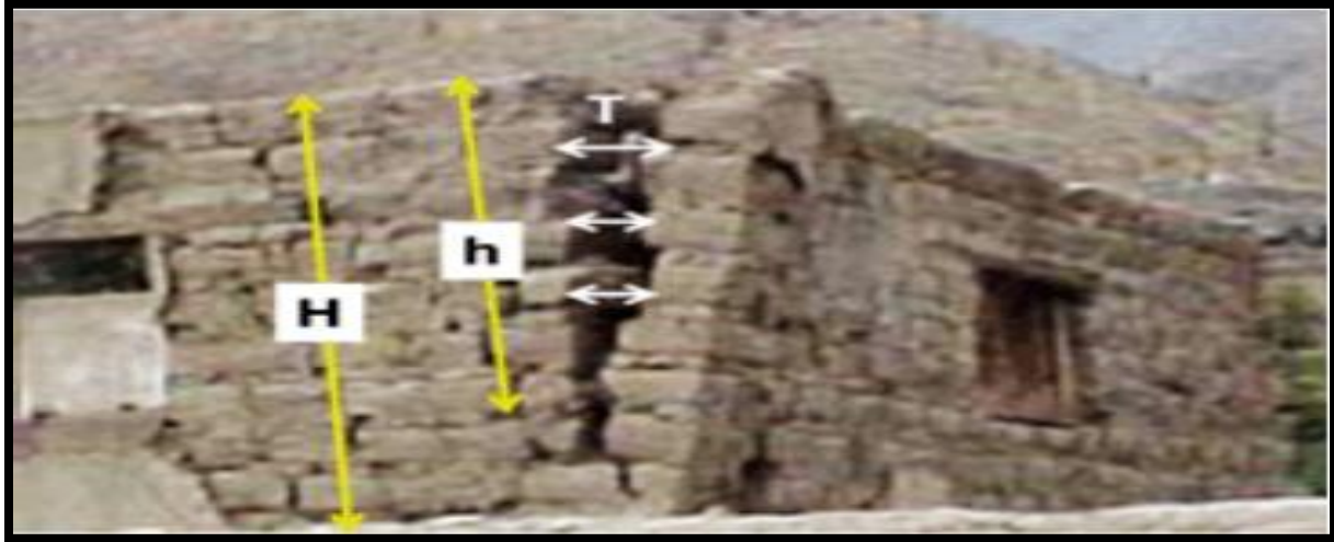
Ilustración 74. Propagación de la falla por desgarramiento en muros Fuente: San Bartolomé y Quiun (2015)
