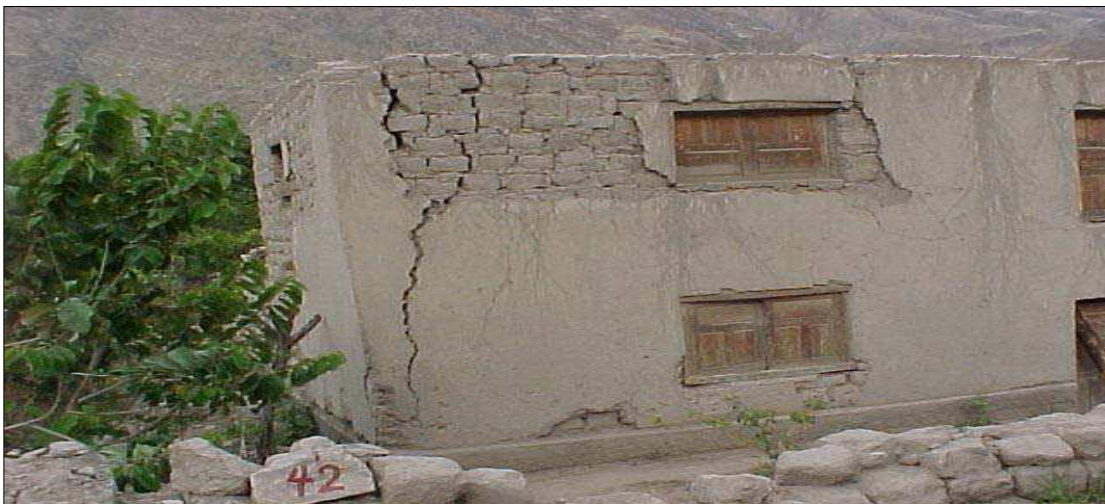
Ilustración 9. Grieta vertical en la esquina. Fuente: Fierro, M. (2011)
