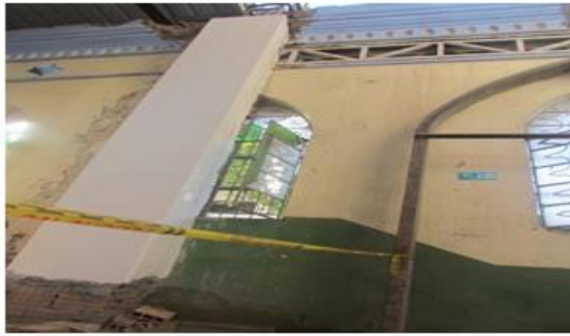
MURO COSTADO ESTE INTERIOR- EJE A - CARACTERÍSTICAS DE LOS MATERIALES Y ESTADO
