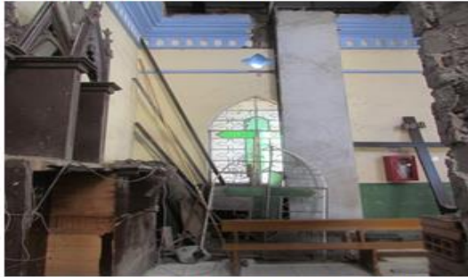
MURO COSTADO ESTE INTERIOR- EJE A - CARACTERÍSTICAS DE LOS MATERIALES Y ESTADO
