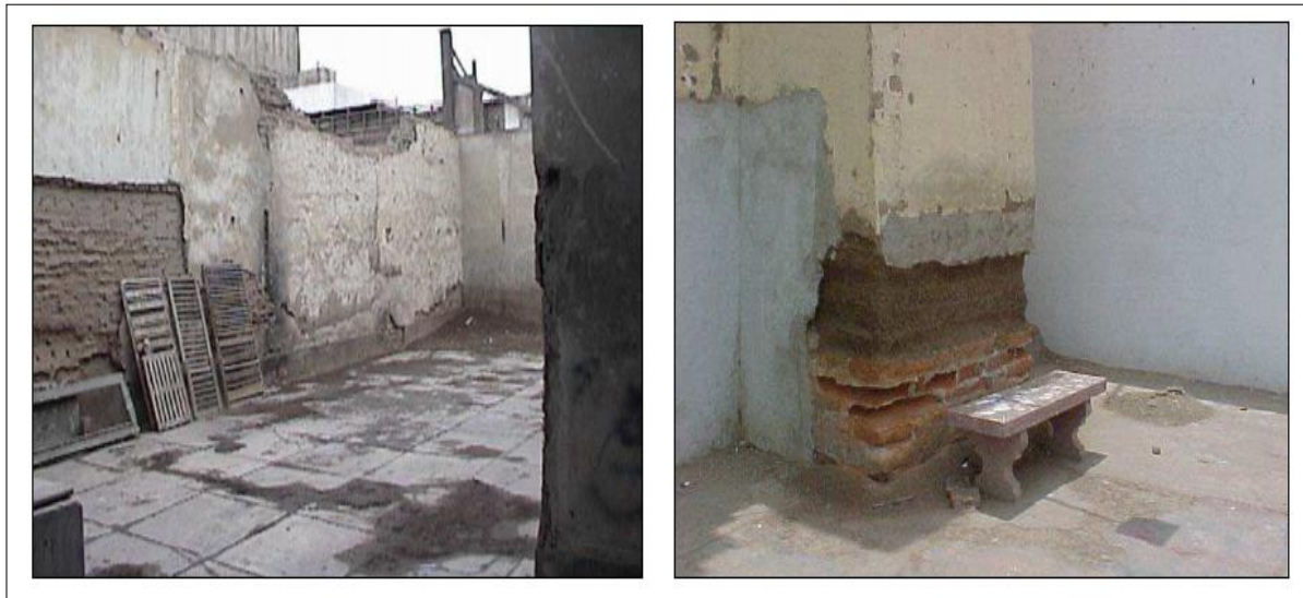
Ilustración 17. Erosión en muros y pérdida del recubrimiento. Fuente: Fierro, M. (2011)
