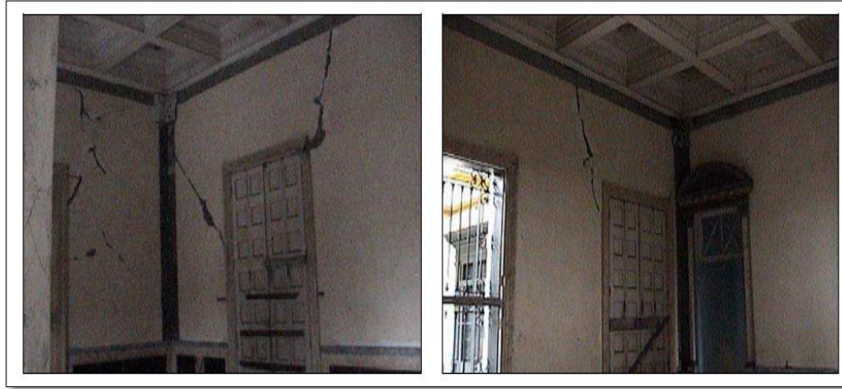
Ilustración 13. Grietas desde los vanos Fuente: Fierro, M. (2011)
