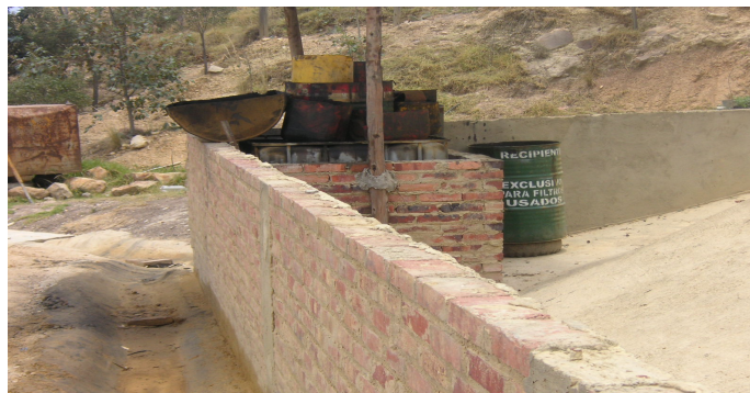
Figura 12: Tanque para almacenamiento de aceites usados
