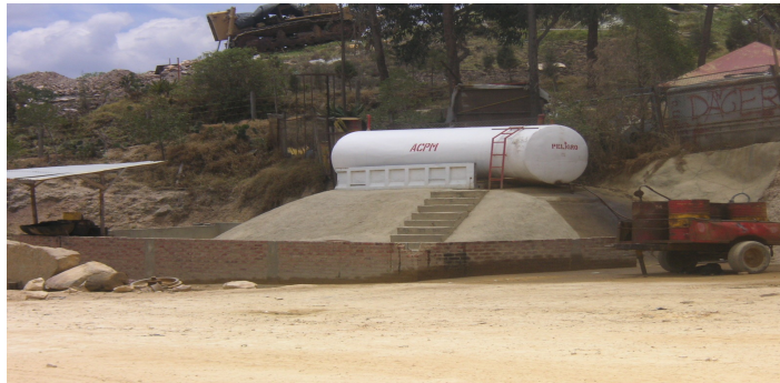
Figura 11: Foso perimetral para el control de derrames de combustibles
