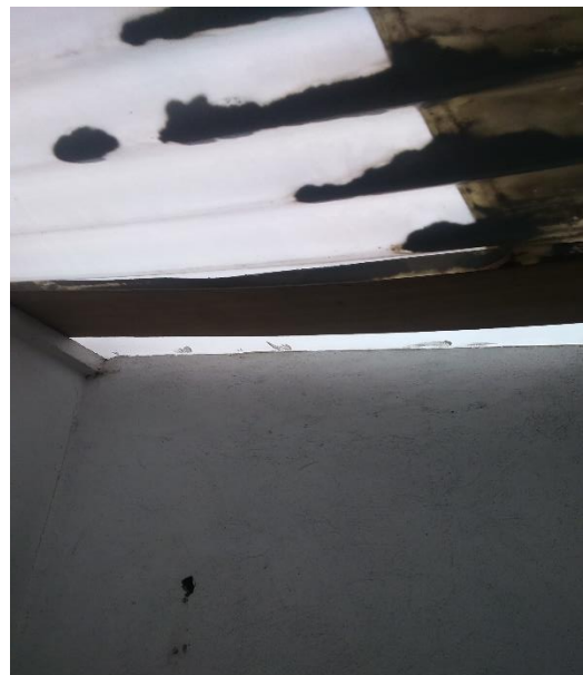
Imagen No.4. Posibles Filtraciones (Parra, 2016).
