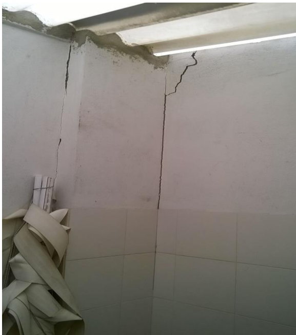
Imagen No.3. Fallas en la estructura (Trujillo, 2016).
