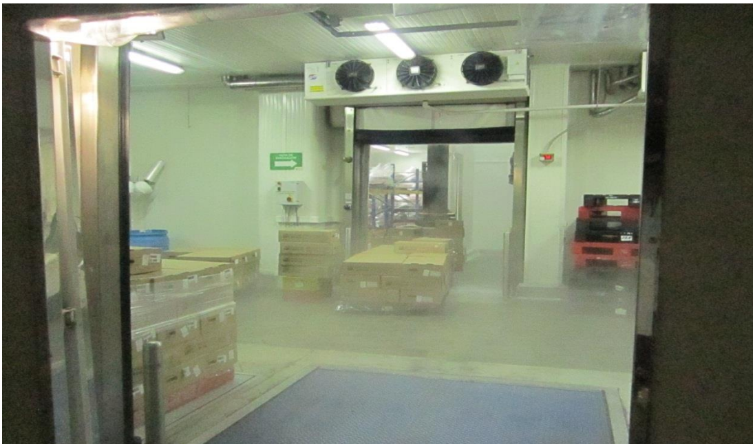
Figura 1: cámara de refrigeración
