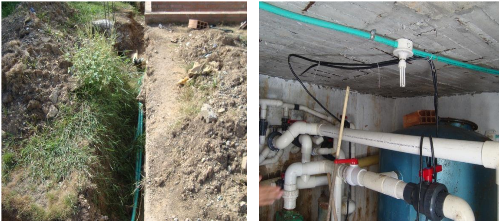
Fotografía: evidencia de deficiencia de instalaciones eléctricas en sala de maquinas Piscina n. 2 Alto Magdalena (24/07/2013)
