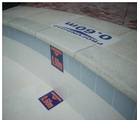
Fotografía: Mestra correcta de instalación de baldosas de señalización Piscina
