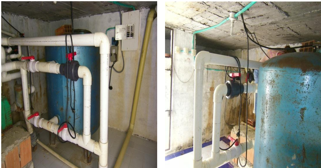
Fotografía: evidencia de deficiencia de instalaciones electricas en sala de maquinas Piscina n. 2 Alto Magdalena (24/07/2013)
