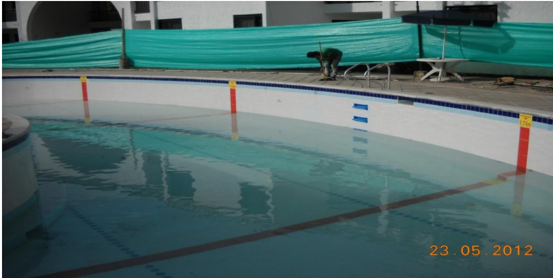
Fotografía: Muestra correcta de instalación de baldosas de señalización Piscina Piscina Gran Vía Hotel Peñalisa Colsubsido
