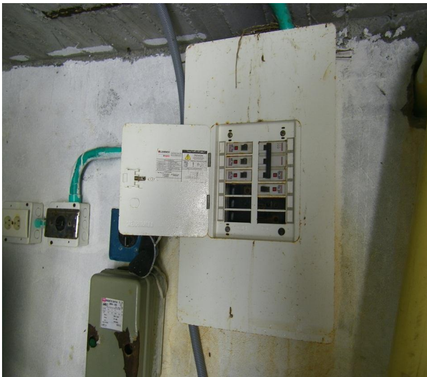
Fotografía: evidencia de deficiencia de instalaciones electricas en sala de maquinas Piscina n. 2 Alto Magdalena (24/07/2013)
