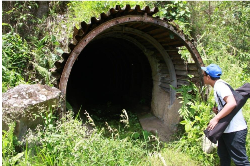
Tubería instalada con el fin de sacar agua de la montaña, pero no funcionó- foto por GeraldineLaura A. Taborda
