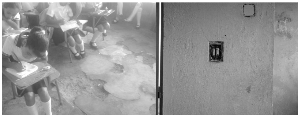
Figura 5. Aula de clase de la Sede Villa Esperanza. A la izquierda el deterioro de los pisos y a la derecha los circuitos eléctricos.
