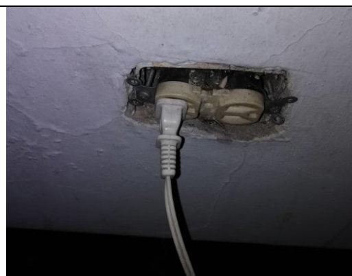
Riesgo electrico en oficina.
