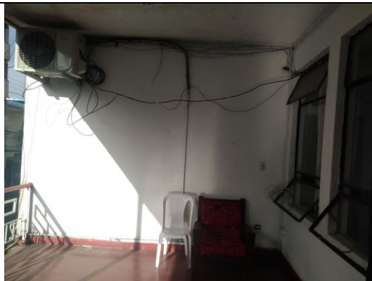
Identificación de riesgos electricos
