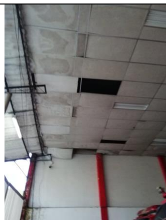
Riesgo locativo en cielo raso.
