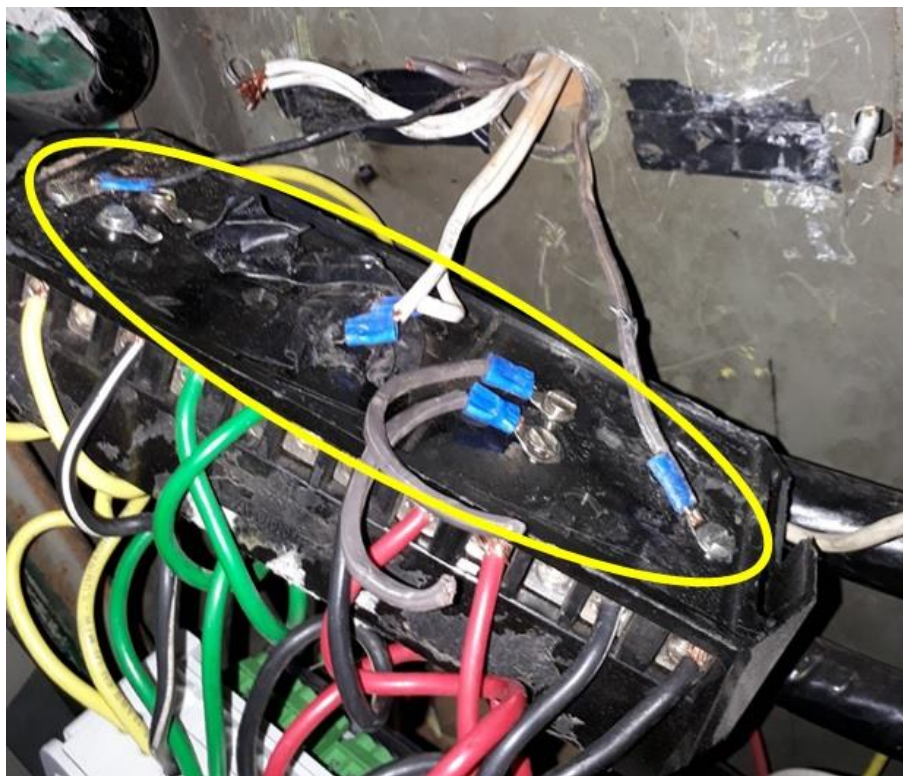
Figura 6. Alteración en los elementos de medición. (Fotografía suministrada por EPM)
