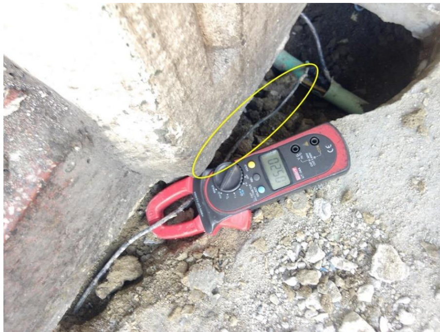
Figura 4. Derivación en la acometida. (Fotografía suministrada por EPM)
