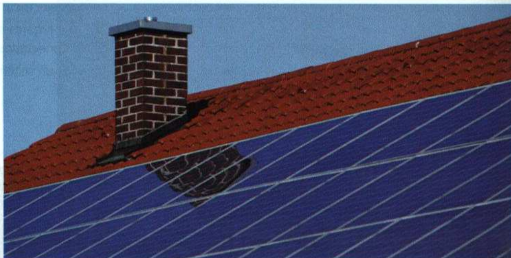
↑ Figura 5.2. Sistema fotovoltaico instalado en el tejado de una vivienda.
