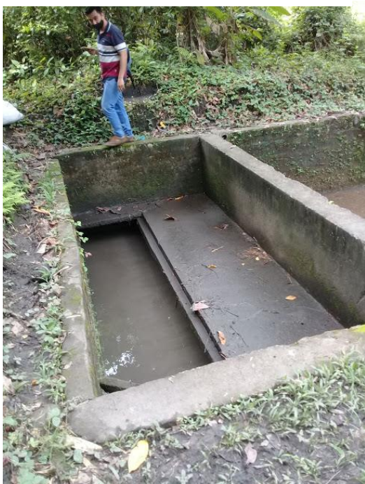
Imagen 435. Cámara de separación tanque desarenador. Autor
