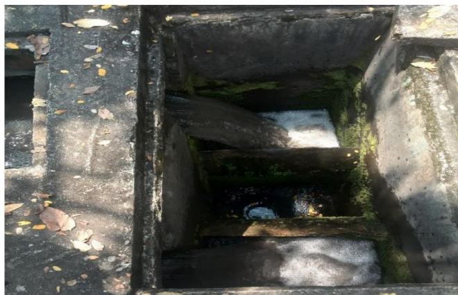
Imagen 444. Repartidor de caudales. (Becerra y Alvarado, 2018)
