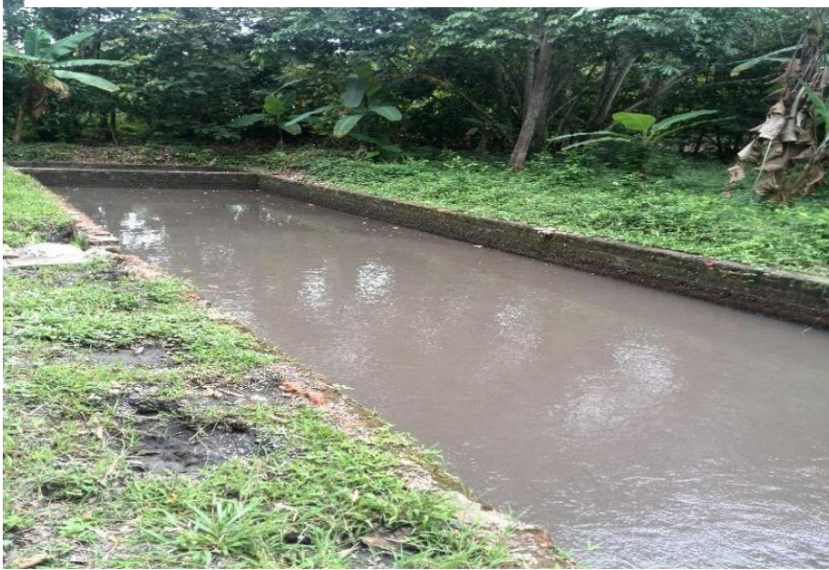
Imagen 417. Desarenador acueducto municipal (2018). ( Becerra y Alvarado, 2018 )
