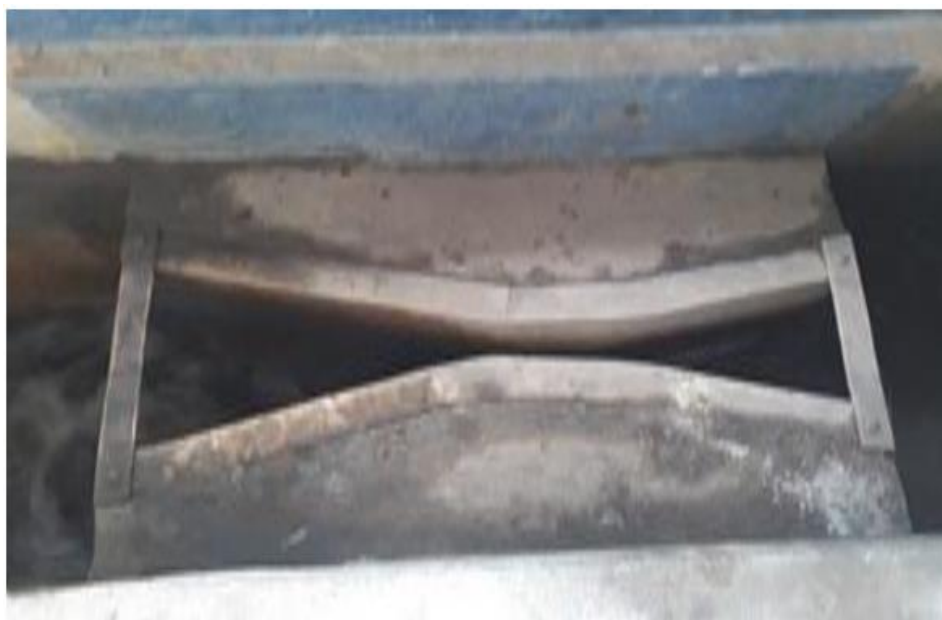
Imagen 453. Canaleta Parshall. (Becerra y Alvarado, 2018)
