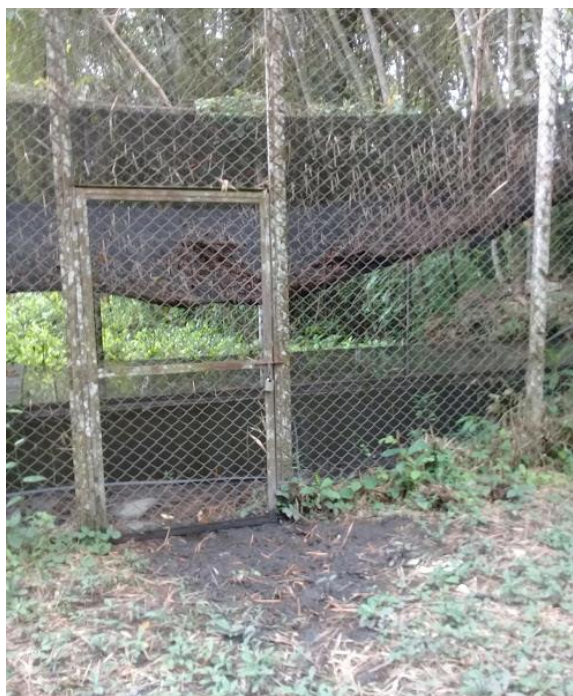
Imagen 381. Tanque desarenador acueducto veredal. Autor
