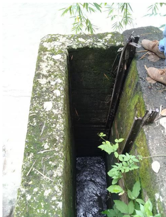
Imagen 255. Vista interna cámara de captación. Autor
