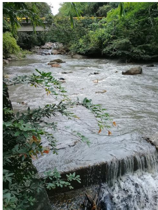
Imagen 309. Ausencia de Rejilla de bocatoma. Autor
