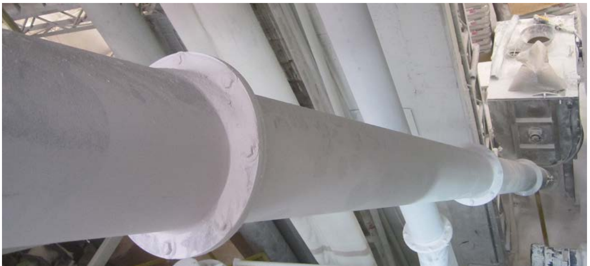
Ilustración 32. Tornillo Sin Fin desde plataforma
