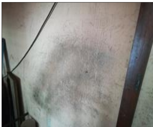
Figura 14. Estado de las paredes en Fabrintec Ltda.
