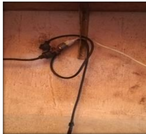
Figura 27. Instalaciones eléctricas en la oficina de Fabrintec Ltda
