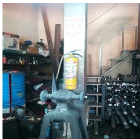
Figura 33. Extintor ubicado en la parte posterior de la bodega de Fabrintec Ltda.
