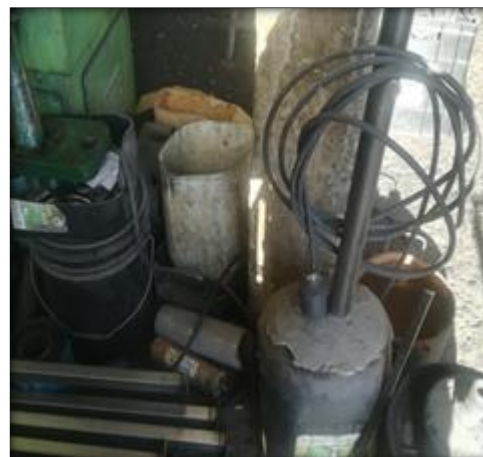
Figura 26. Cables en zonas el piso de Fabrintec Ltda Fuente: Autores, 2019.
