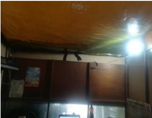
Figura 21. Escasa iluminación en la oficina de Fabrintec Ltda.
