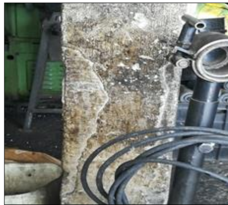
Figura 13. Estado de las columnas de Fabrintec Ltda
