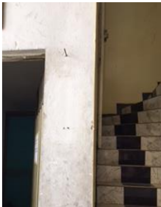
Figura n° 17 ausencias de extintores
