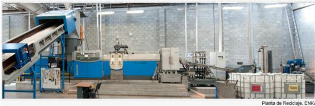
Figura 10. Planta de reciclaje Enka.
