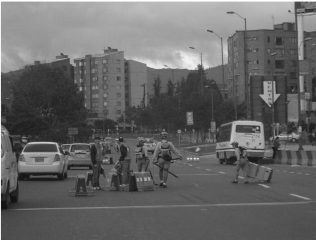
Figura 3: Ubicación de material de cerramiento (500 m. al norte de la Av. Boyacá con Calle 80).Fotografía: Sandy Cely Rico, (2013).
