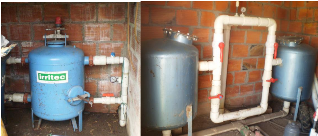
Figura 9. Tanques de filtración (Núñez & Rizo, 2014).
