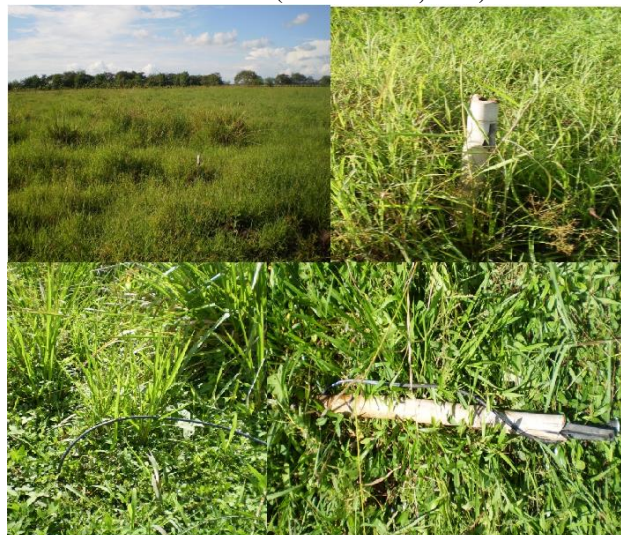
Figura 15. Estado actual del sistema, Lote 2 – Santa Lucía, obsérvese el crecimiento excesivo del pasto y daño en las bases de los microaspersores (Núñez & Rizo, 2014).
