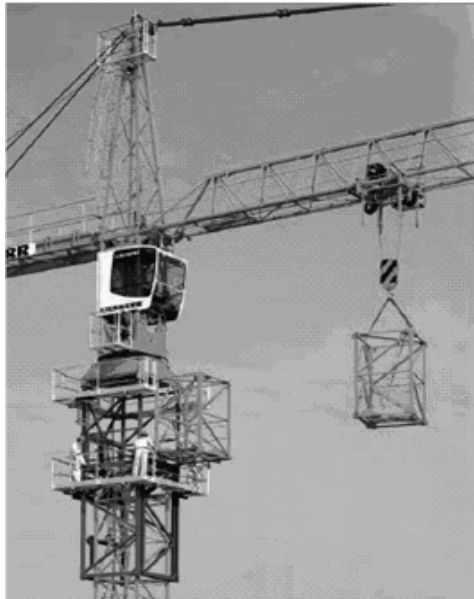
Figura 1.2. Mastil de la torre grúa
