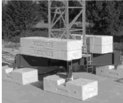
Figura 1.5. Contrapeso de la torre grúa
