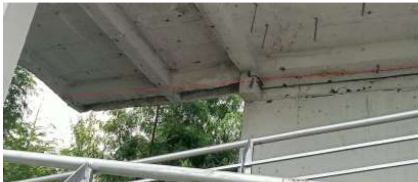
Imagen 10 – Vista deflexión voladizo placa tanques – Fuente: Autor
