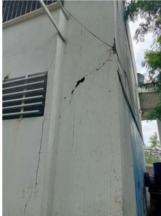
Imagen 8 – Vista de grieta de cortante en columna costado oriental – Fuente: Autor
