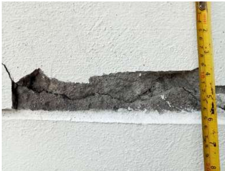
Imagen 7 – Detalle desprendimiento del concreto en viga zona escaleras – Fuente: Autor
