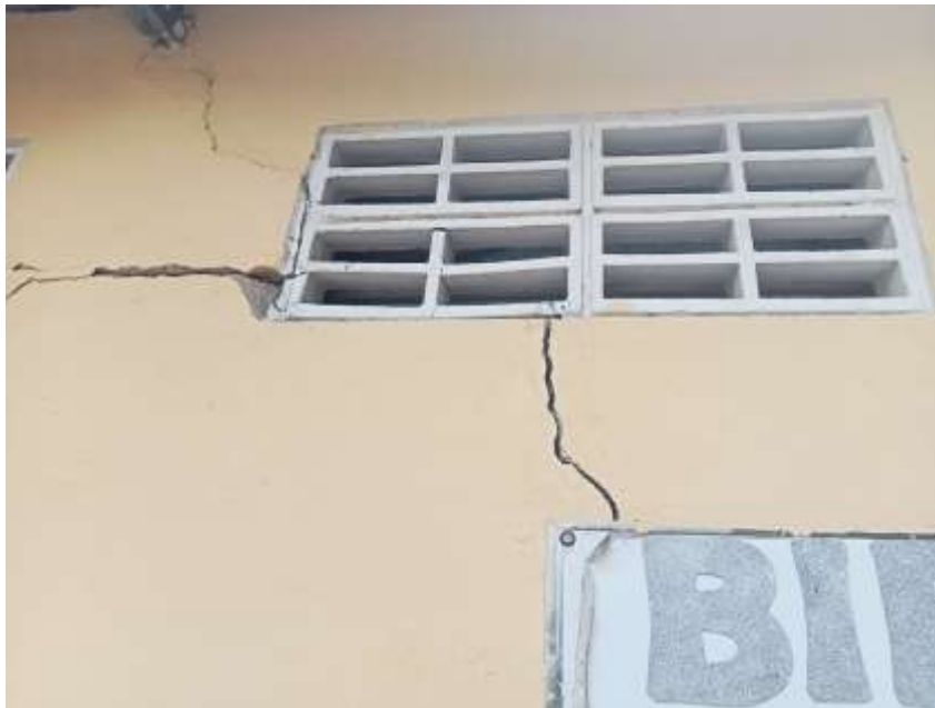
Imagen 11 – Vista falla en elementos de mampostería en bloque administrativo – Fuente: Autor
