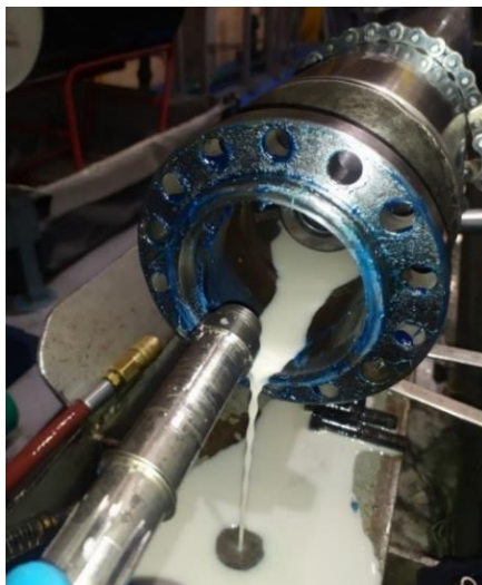
Eje de bomba WE 1500 H fracturado, [fotografía] imagen propia 2021.
