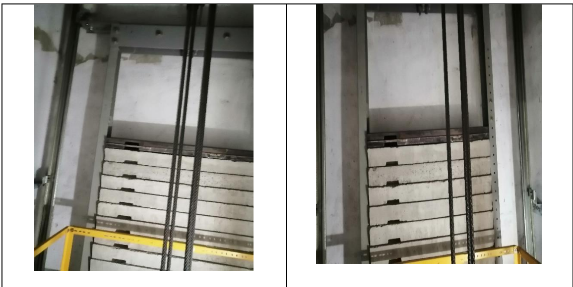
Imágen 2: Exposición Riesgo Mecánico: Atrapamiento con Objetos Móviles (contrapeso)
