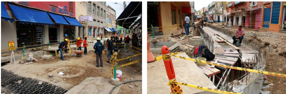
Figura 4. Impacto de las obras civiles en bloqueo del comercio del centro de Barranquilla, 2018
