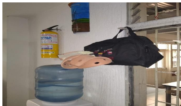
Figura 7. Extintor y botiquín mal ubicados.
