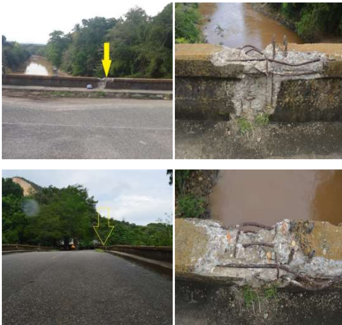
Figura.37 Evidencia de daño producido sobre la baranda del puente
