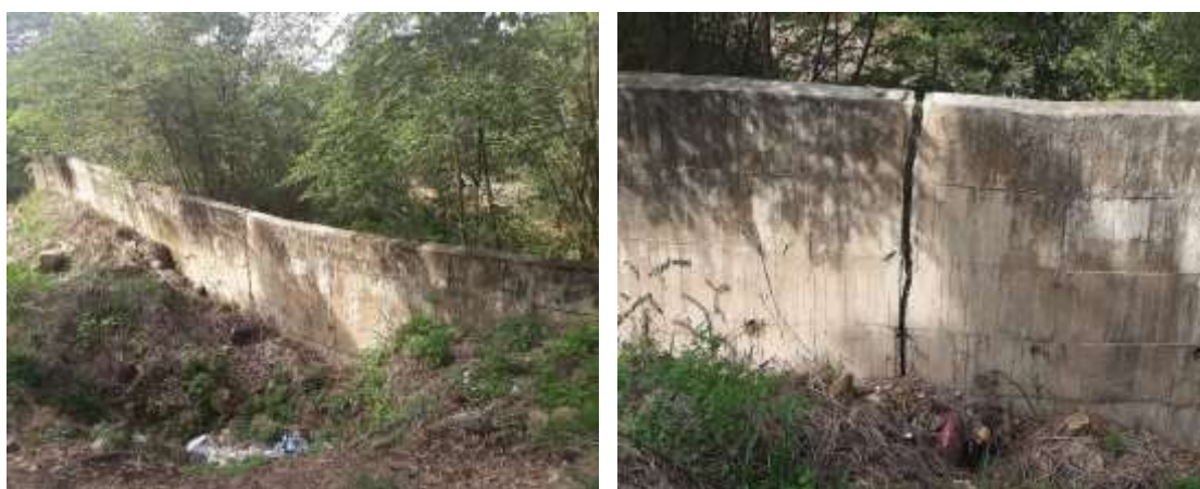
Figura 32. Fractura En Muro De Ala
