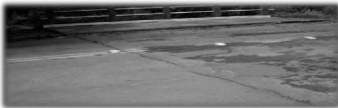
Figura 6. Fotografía De Las Grietas En Las Juntas Y Deterioro Del Pavimento.
