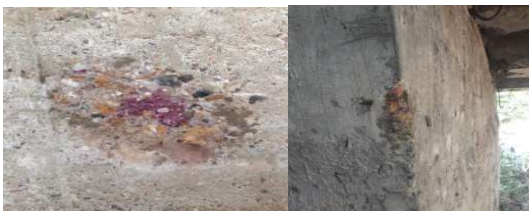
Figura. 42 Parte de Macizo de Anclaje rociado con Fenolftaleína
