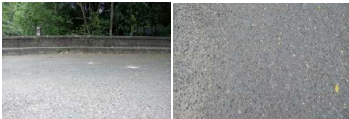
Figura 33. Estado De La Capa De Rodamiento
