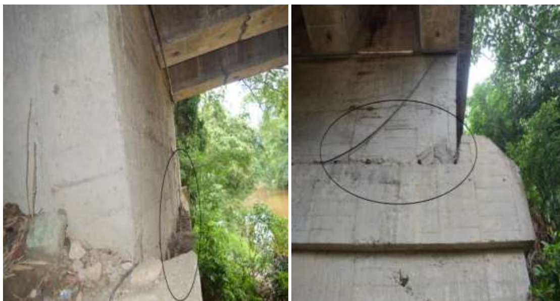
Figura 31. Descascaramiento De Concreto En La Base
