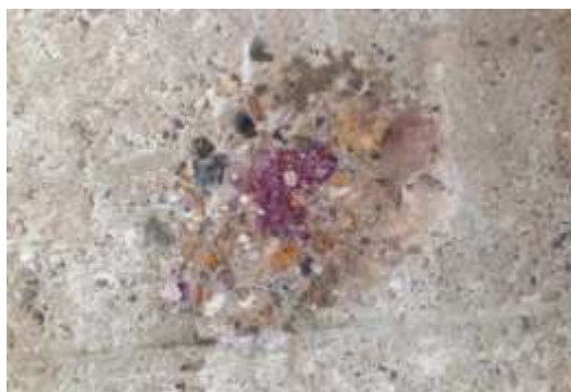
Figura. 43 Parte de Macizo de Anclaje rociado con Fenolftaleína (Ricaurte)
