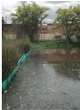
Colmatación de la laguna de sedimentación
