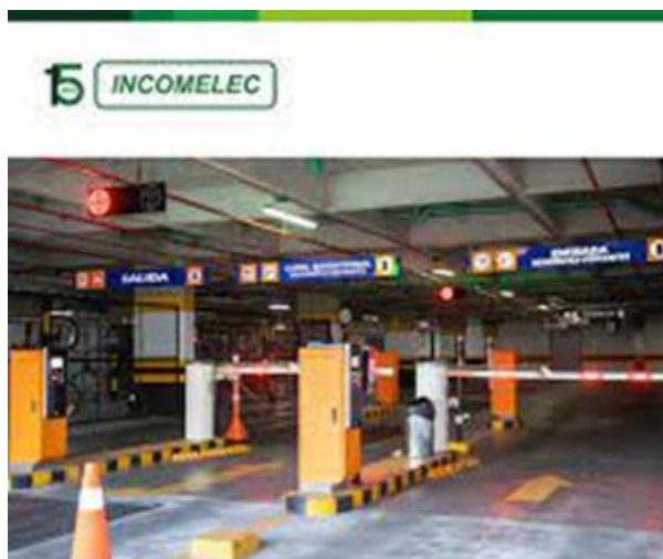
Figura 7. Como se puede ver en la imagen ese sería el Sistema de Parqueo que se encuentra en el Centro Comercial Tintal Plaza.
