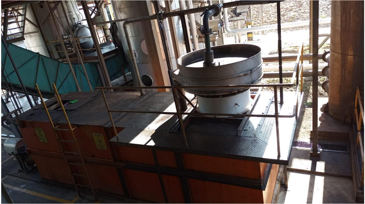
Fotografía de máquina instalada
