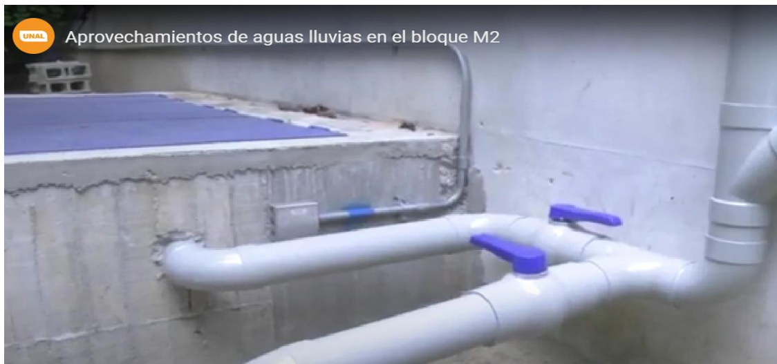
Imagen 6. Minas Medellín UNAL.(2021). Aprovechamientos de aguas lluvias en el bloque M2
