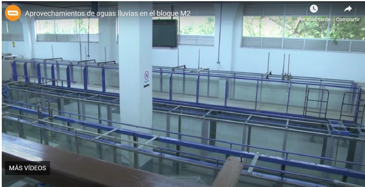
Imagen 9. Minas Medellín UNAL. (2021). Aprovechamientos de aguas lluvias en el bloque M2
