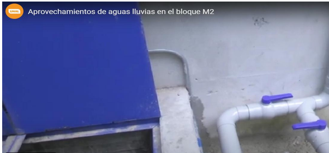
Imagen 5. Minas Medellín UNAL.(2021). Aprovechamientos de aguas lluvias en el bloque M2
