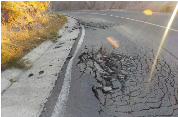
Figura 3. Grietas y deformaciones en la carpeta asfáltica de un pavimento con inadecuada estabilización previa
