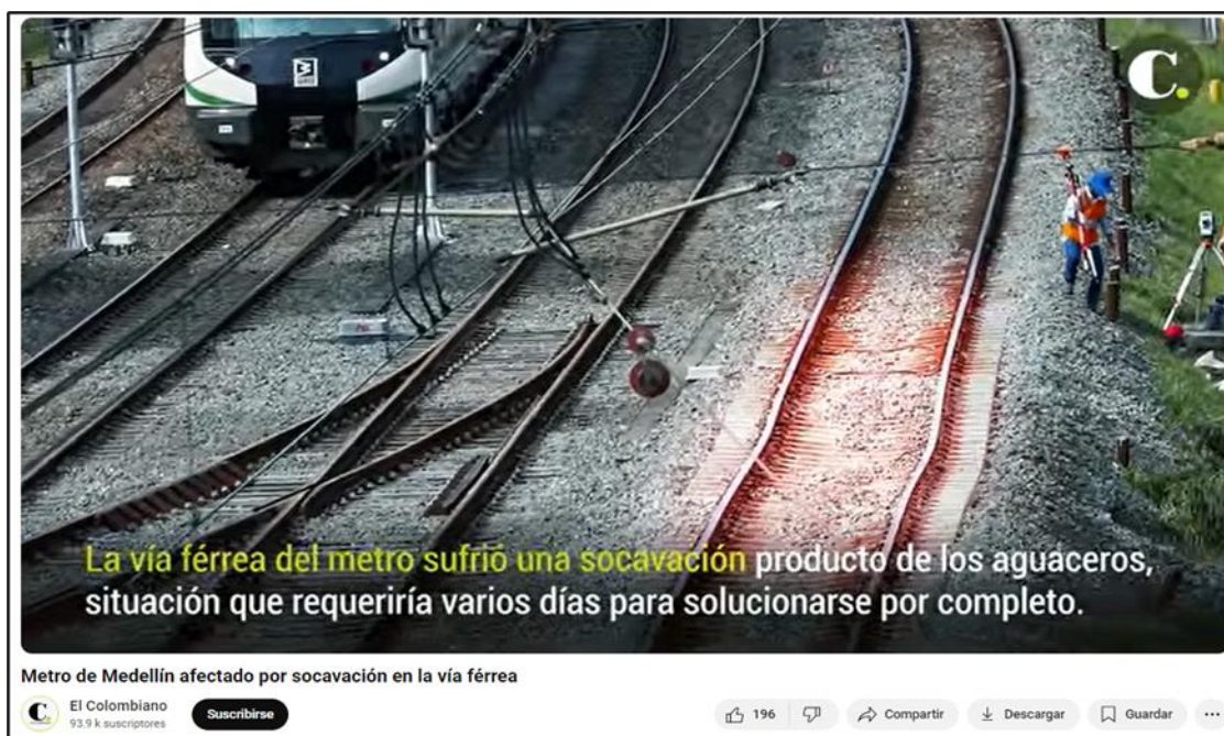
Figura 1: Socavación en la vía férrea del metro de Medellín.
