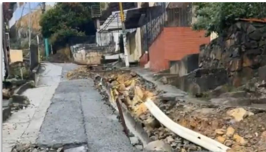
Figura 15: Colapso de redes de alcantarillado en el sector de Siloé
