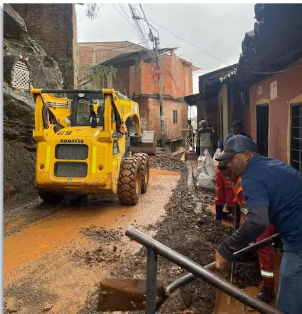
Figura 16: Colapso de redes de alcantarillado en el sector de Siloé
