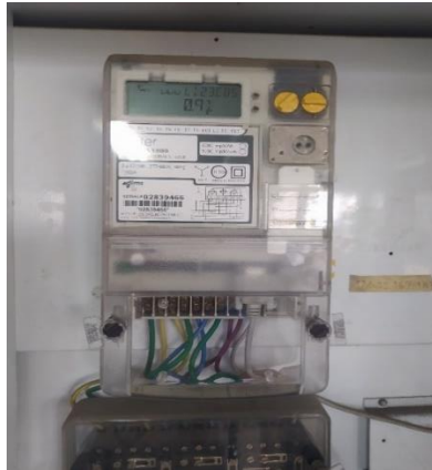
Contador Principal - Marca Elster, Tipo A1800
