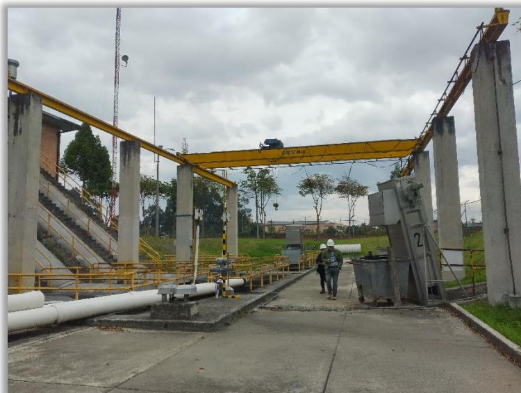
Imagen 3. Maquina limpia rejas de agua lluvia
