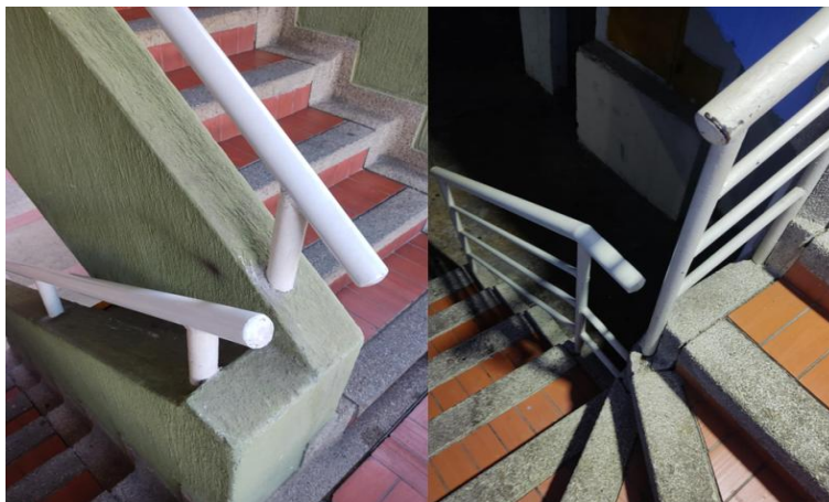
Discontinuidad de escalera
