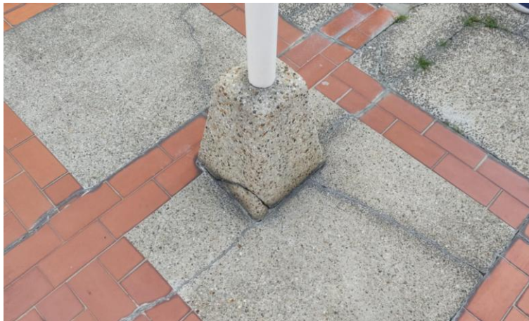
SopORTE de lámparas agrietados y con fisuras
