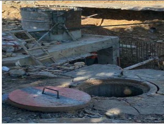
Figura 8. Manejo de aguas negras en función del cambio de manijas y pozos de inspección de alcantarillado.
