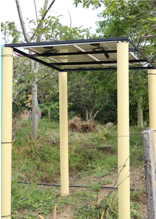
Sistema fotovoltaico implementado en varias fincas vinculadas al proyecto. Sede ECOPRADERA.
