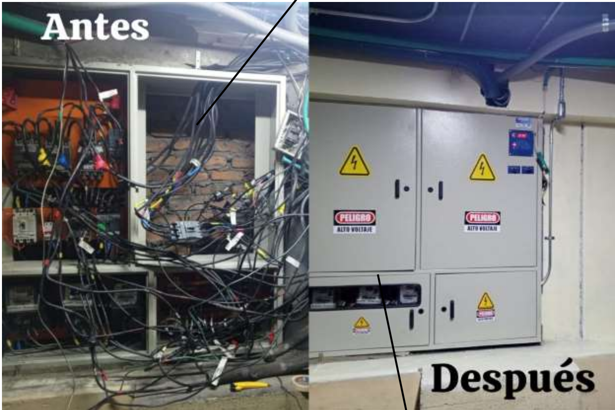
Ilustración 6 Falla de Aislamiento
