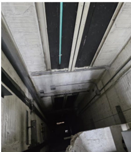
Ilustración 10. Foso de un ascensor x para desplazamiento e izaje de cargas. / Fuente: Propia
