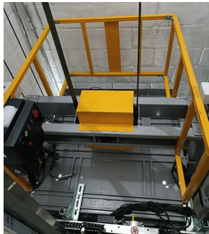
Ilustración 9. Riesgo mecánico en parte superior de la cabina de un ascensor x. / Fuente: Propia
