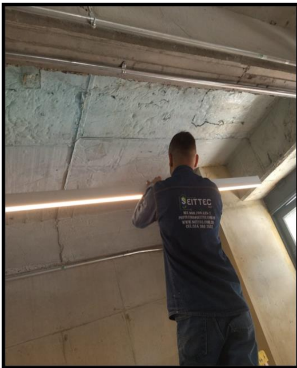
Ilustración 4 “Auxiliar eléctrico instalando luminarias sin EPP”
