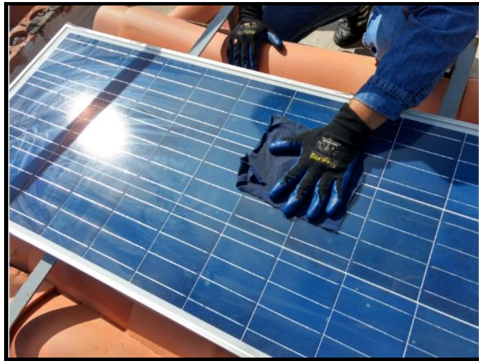
Figura 46. Mantenimiento del Panel Solar Policristalino. Fuente: Autores
