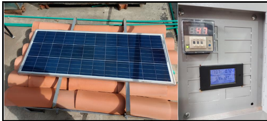
Figura 39. Panel y equipos instalados.
