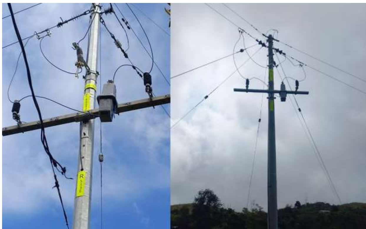
Figura 1B. Lugares de instalación de reconectores monofásicos.
