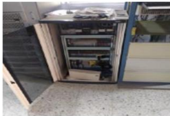
Sistema PLC- fuera de funcionamiento.
