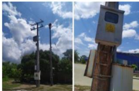
Red eléctrica y contador
