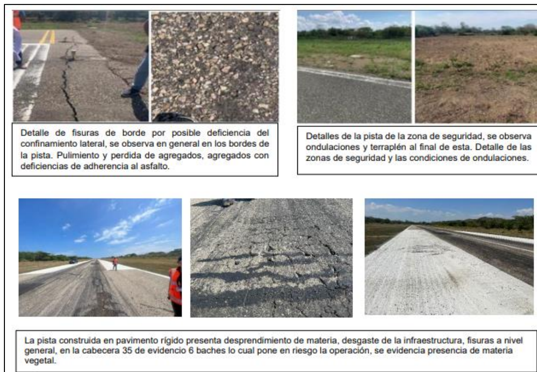
Figura 11. Estado de la pista aeropuerto Golfo de Morrosquillo en el año 2023.
