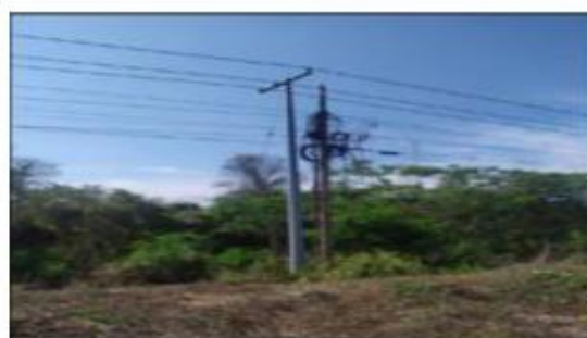
Red eléctrica y de comunicaciones zona de seguridad CAB 35
