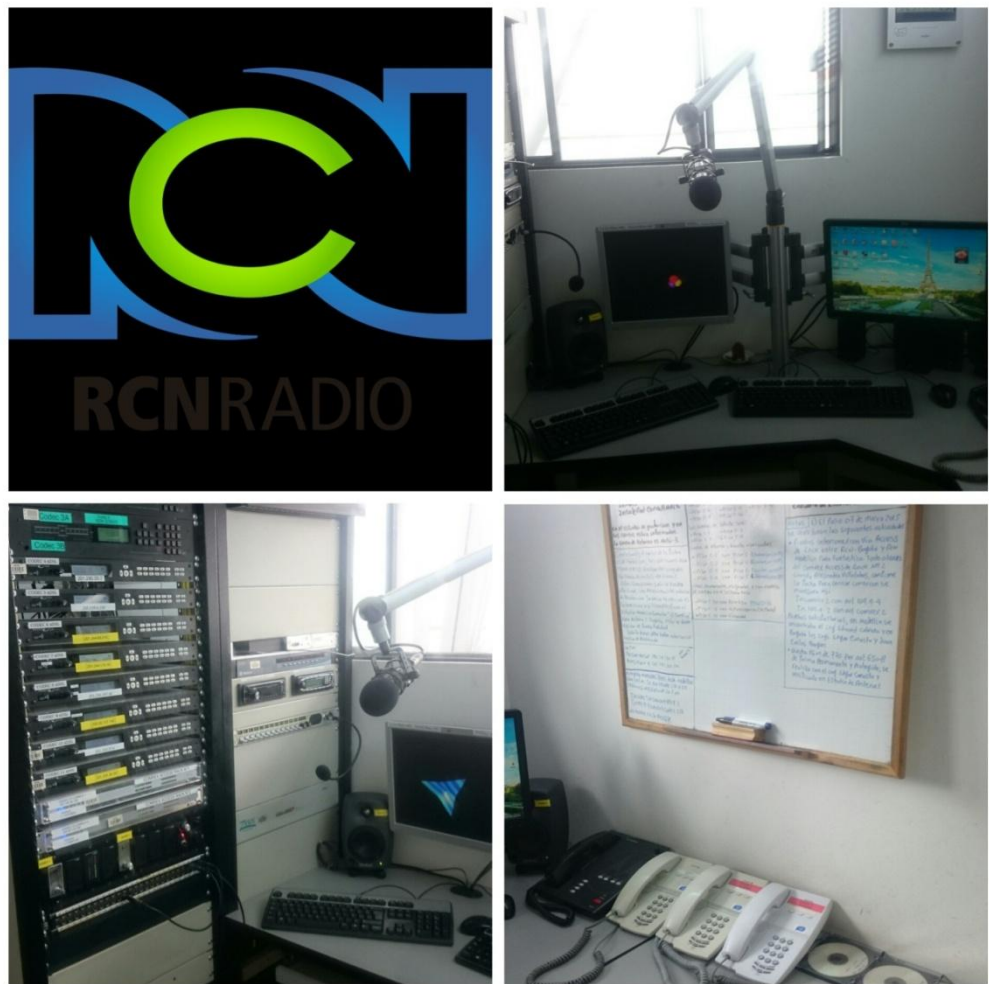
Sala de conmutación
