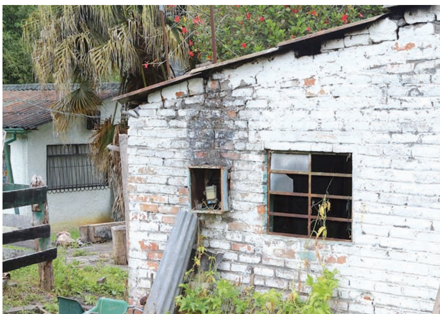
Figura 12. Muros que evidencian condiciones deficientes de habitabilidad. Fuente: PCIS, 2015.
