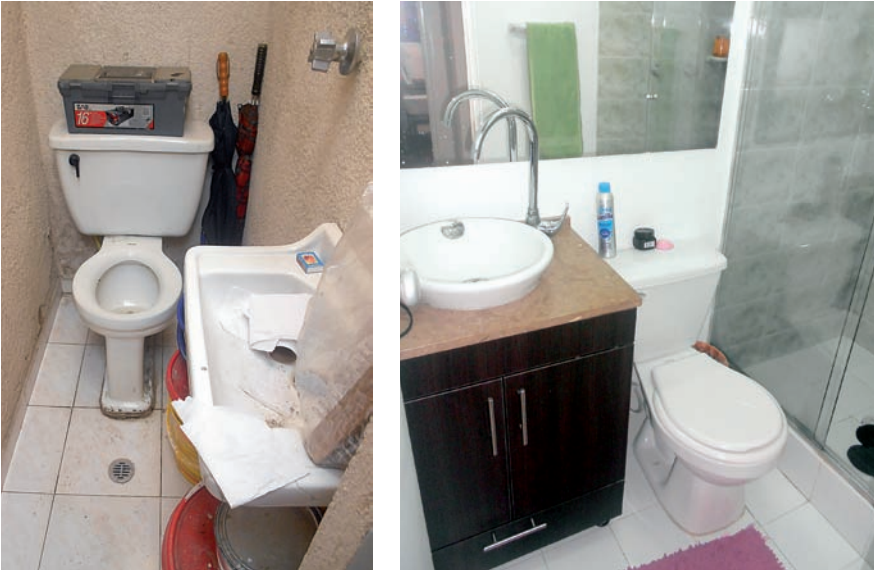
Figura 11. Diferencias en unidades sanitarias para limpieza.
