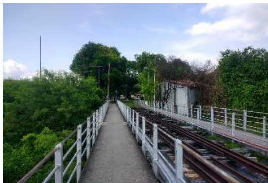
Figura 52 Puente férreo en mal estado
