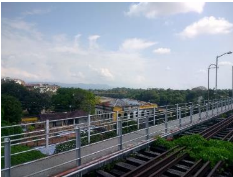
Figura 66 Puente férreo en estado de deterioro
