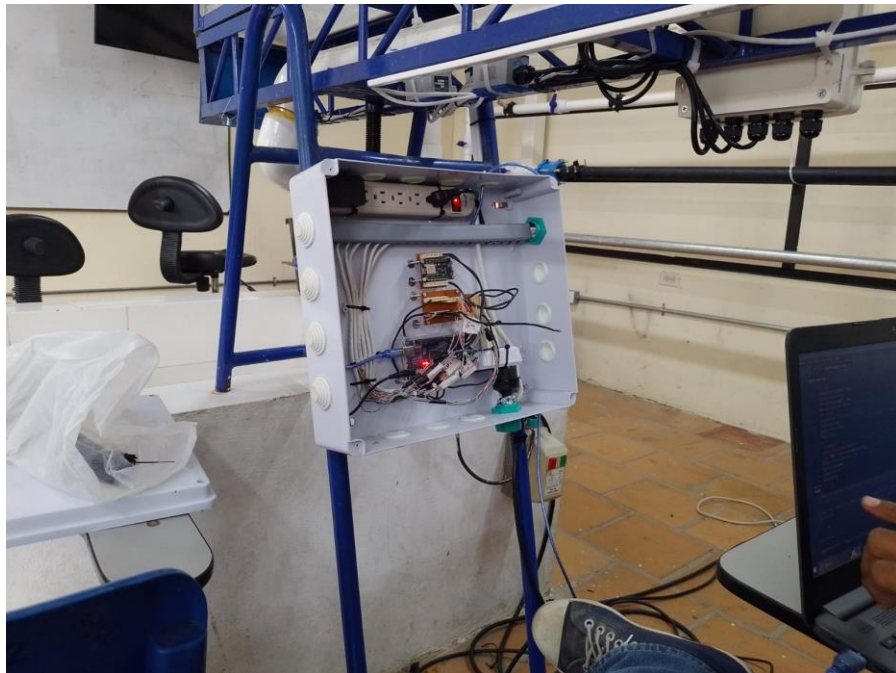
Anexo 6 Tablero de control de los sensores
