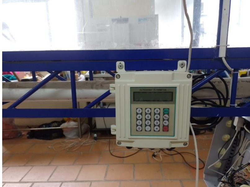
Anexo 5 Sensor de medidor de caudal
