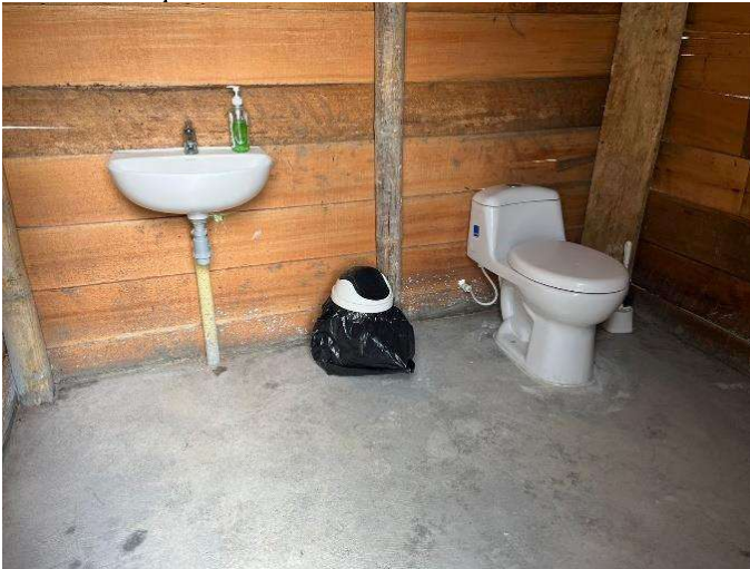
Figura 7. Bateria sanitaria instalada. Elaboración propia (2023)
