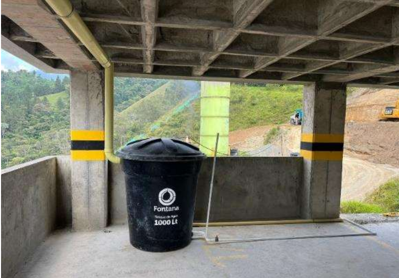
Figura 6. Tanque de almacenamiento capacidad 1000 lt y tubería de recolección y conducción de agua lluvia, fuente propia (2023)
