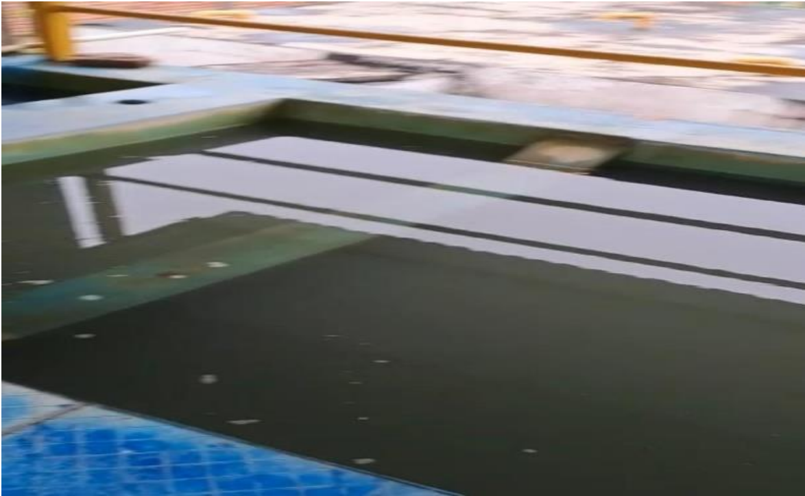
Ilustración 14 canal de aguas sedimentadas
