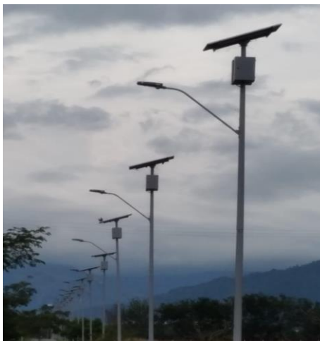
Imagen 10 Alumbrado público fotovoltaico alineado por la vía al aeropuerto
