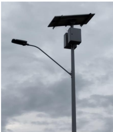
Imagen 9 Alumbrado público fotovoltaico con estructura de iluminación led, panel fotovoltaico, adaptador y batería
