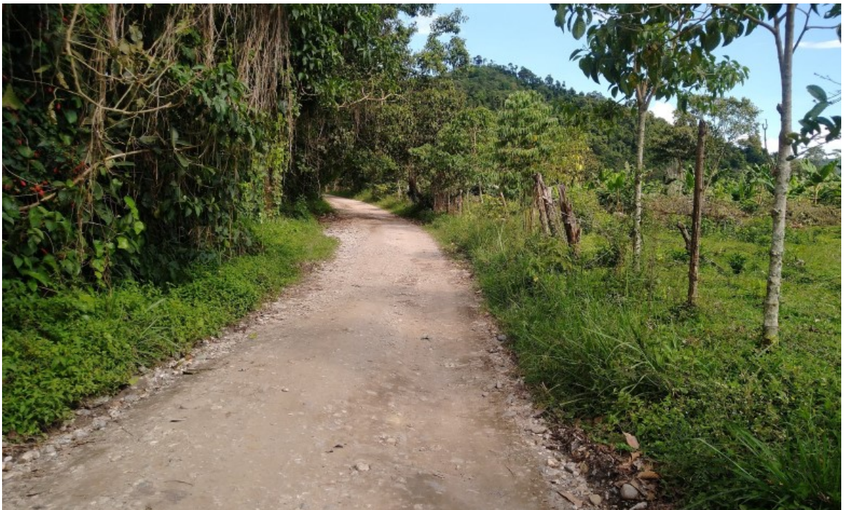
Figura 2 Vía Vereda Trinidad-Santa Teresa K5+500. Ausencia de drenaje longitudinal
