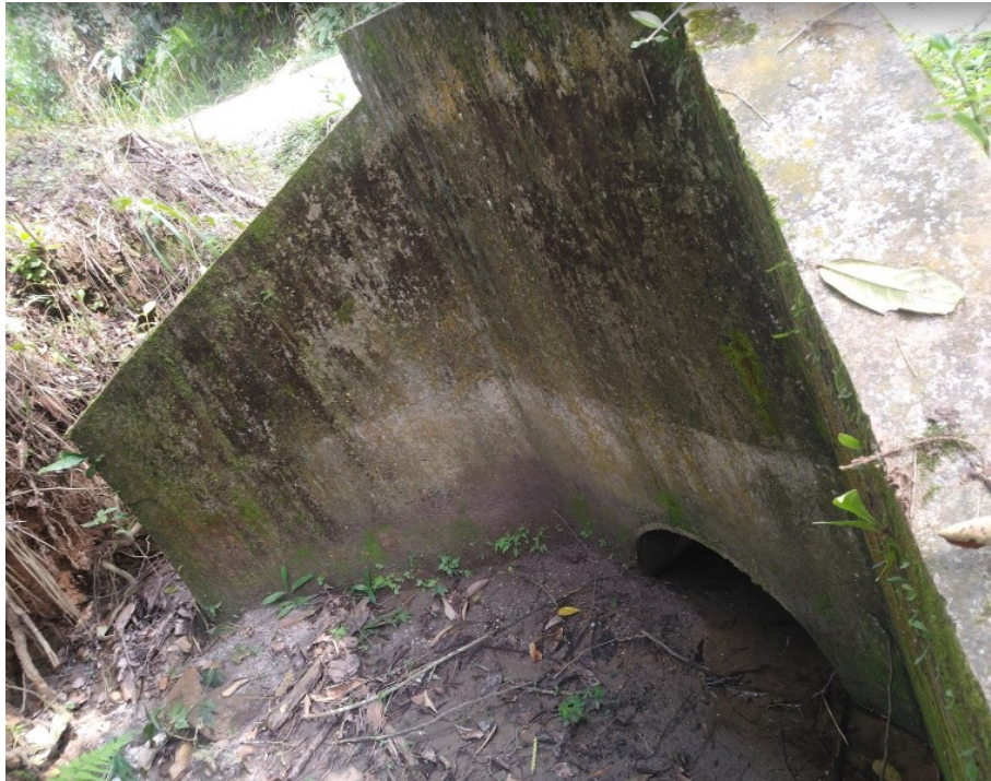
Figura 6 Obstrucción de Alcantarilla a la mitad de su capacidad
